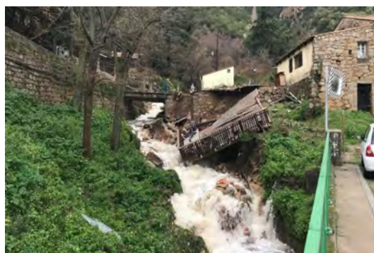
Illustration 43 : Inondation de 2019 dans la commune d'Ocana (Source : France 3 région)
