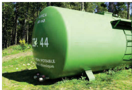
Cuve DFCI en forêt sur une ZAL
