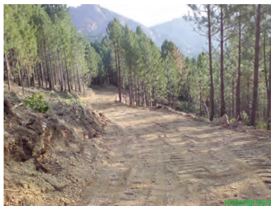
Ouverture d'une bande de roulement dans le cadre de la création d'une ZAL
